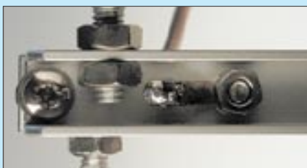
Bild 7: Der Innenleiter der Speiseleitung führt über eine Lötöse an die obere Boomstrebe.
